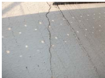
開口まわりのクラック
