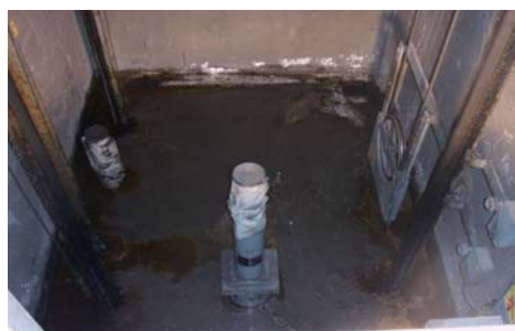
エレベーターピットの漏水
