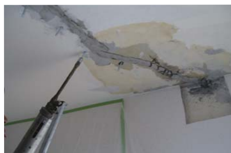
天井からの漏水
