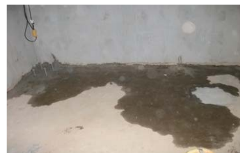
地下室の漏水
